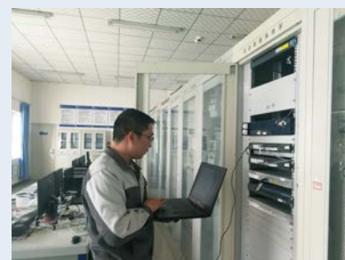
网络信息安全防护-软件调试消缺
