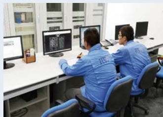
甘肃敦煌安洁电站值班室监盘
