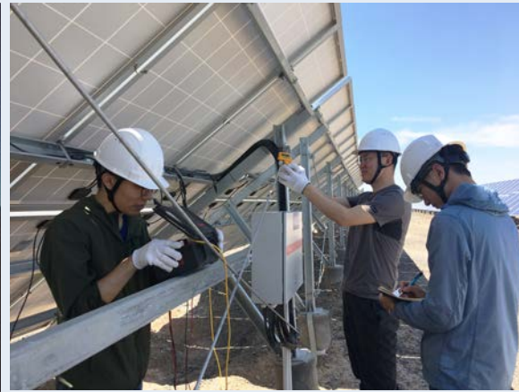
新疆克拉玛依申能电站组串失配率检测
