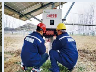
青海海南州协和轩尚电站组串式逆变器排查
