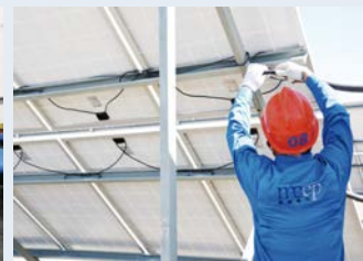
甘肃金昌中科电站组串日常巡检
